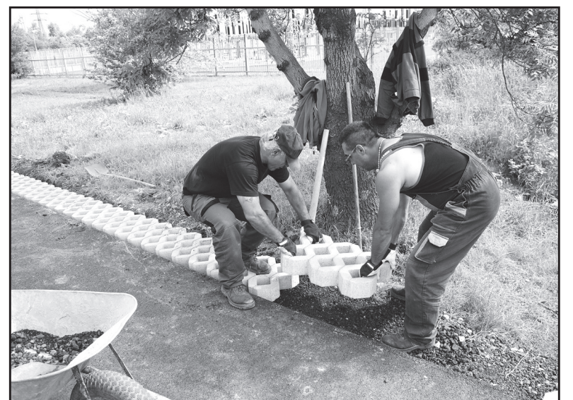
Zatravnovací tvárnice kolem nového chodníku z Otvic do Jirkova pokládají Ladislav Balogh (vlevo) a Zdeněk Gorol. Foto Luboš Mizun
