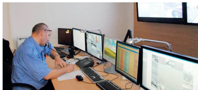
Sledování městského kamerového dohlížecího systému. Foto MěP
