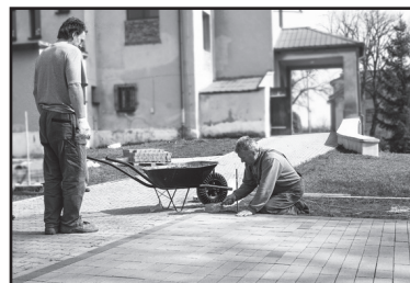
Zároveň s instalací atrakcí byl vydlážděn prostor o rozloze 200 m 2 . V zahradě totiž byl jen travnatý povrch, který v případě vlhkého počasí nebyl vhodný pro pobyt dětí venku.
